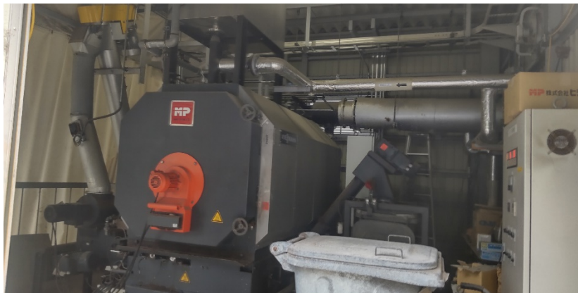
洲本市にある竹チップボイラー。オーストリア製の木質ボイラーを日本の会社が竹チップボイラーとして改造。
