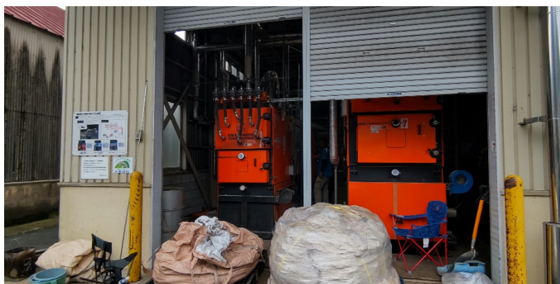
村役場裏にあるボイラー2基。一方が熱、もう一方が熱電併用。
